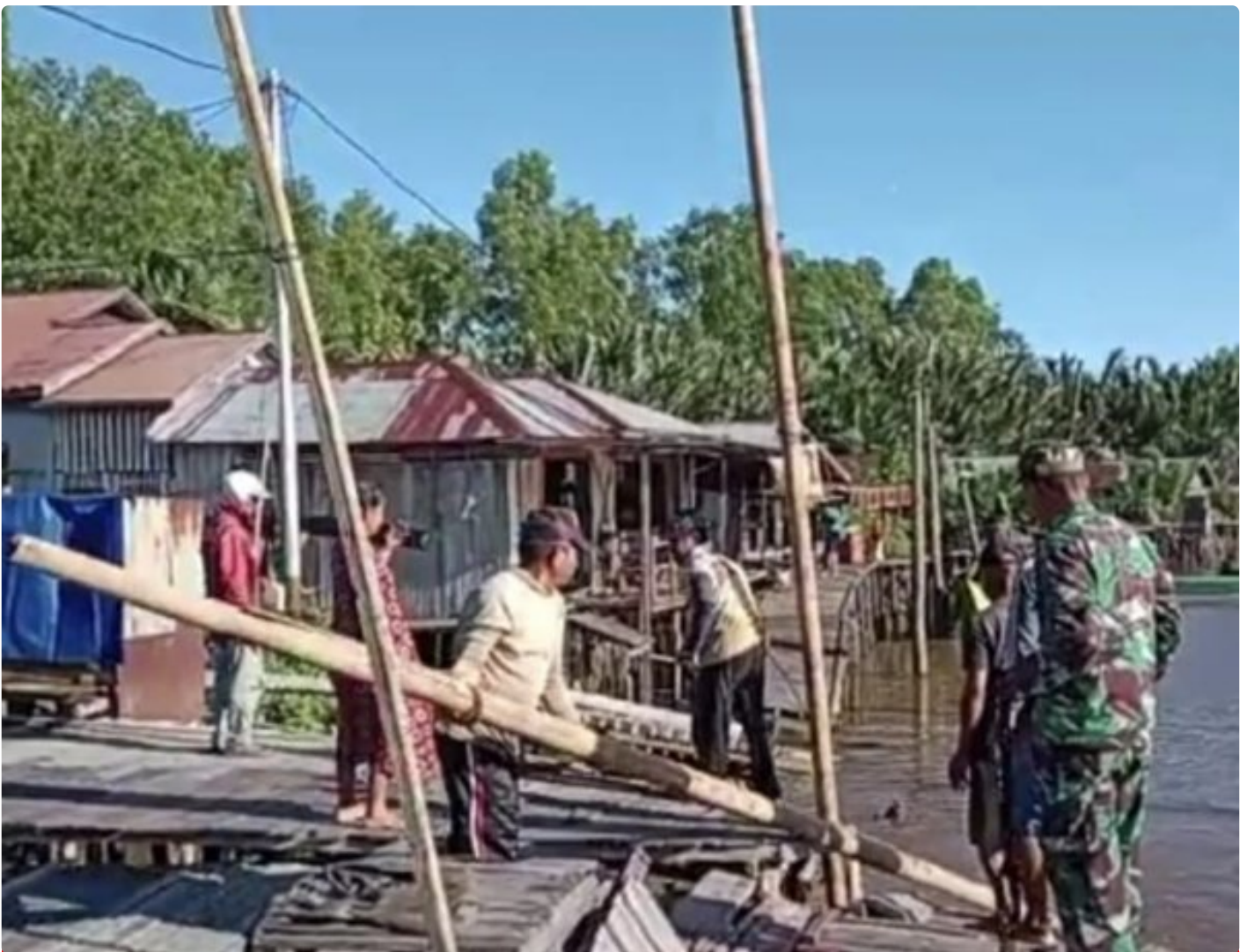
Kondisi Jalan Titian Desa Labat Muara Rusak " Kini Dikerjakan Warga Dibantu Babinsa
